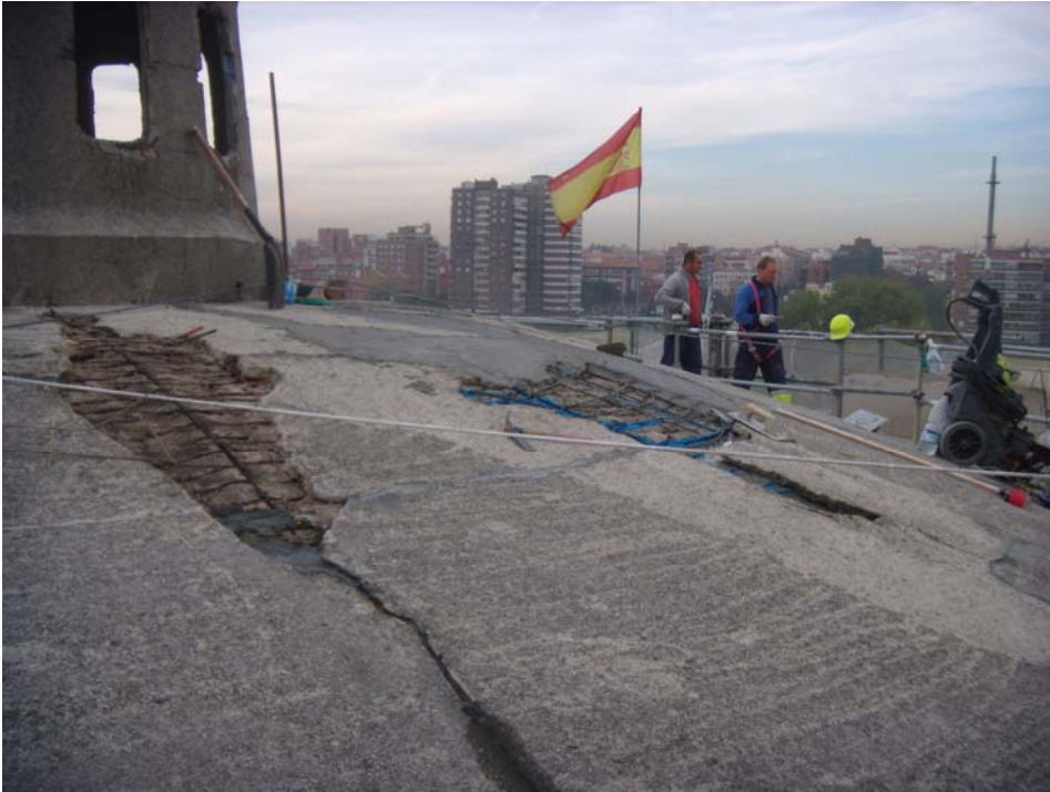
Fig. 4 Reparación de los graves daños de la cubierta de la cuba del depósito
