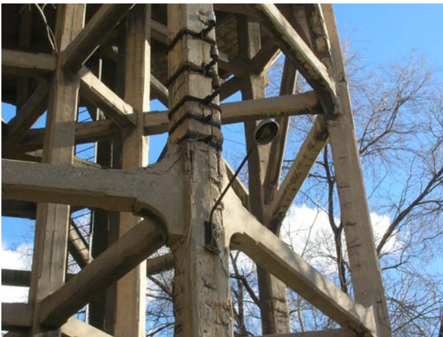
Fig. 2 Estado de daños sufridos por las armaduras del depósito
